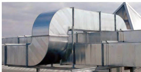
Gaines d'aération et climatisation
